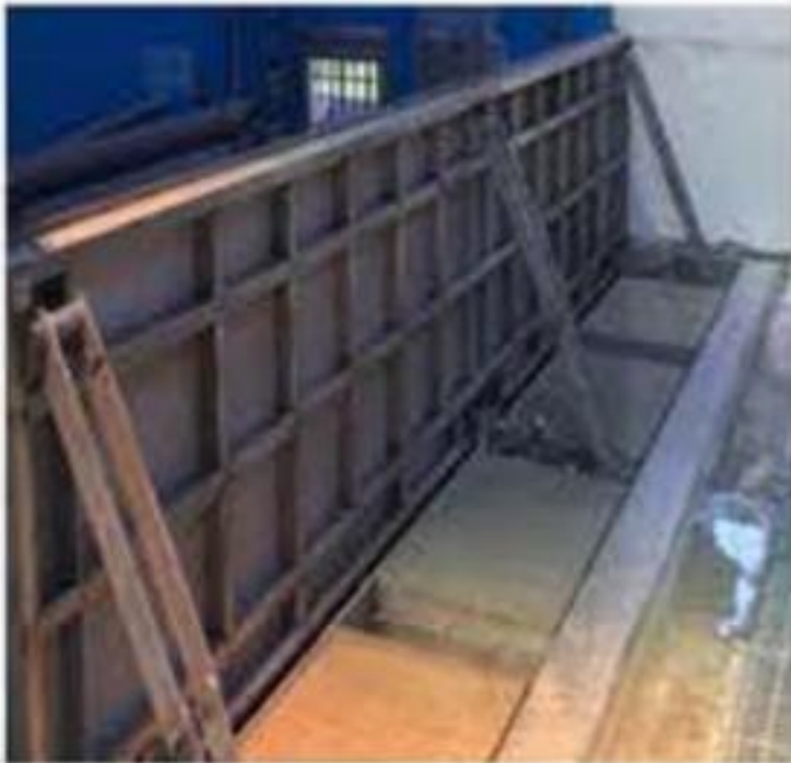
油压电动防洪闸门
